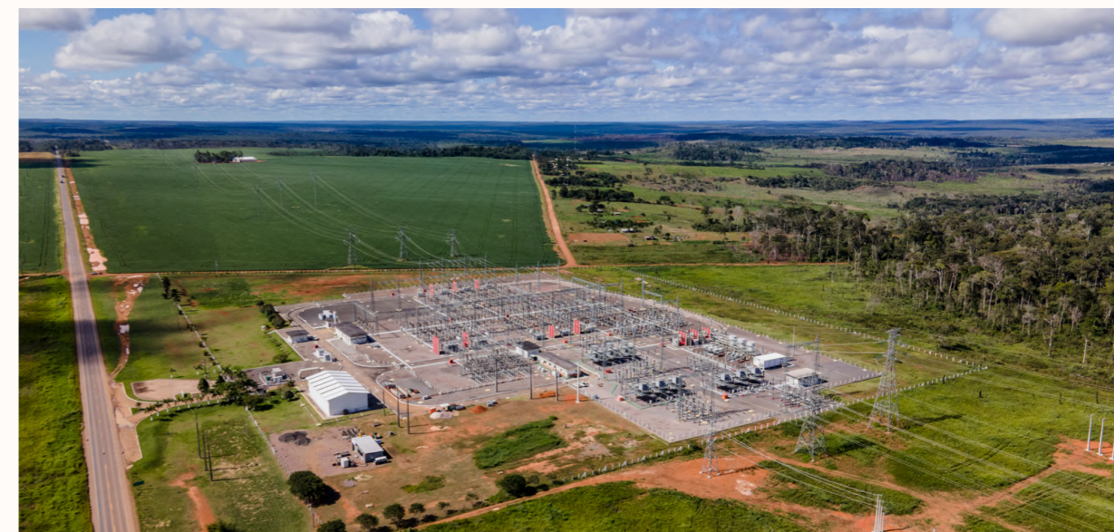
Subestação Vilhena, JTE
