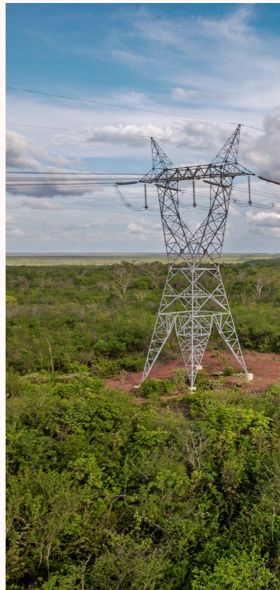
Linha de transmissão SITE
