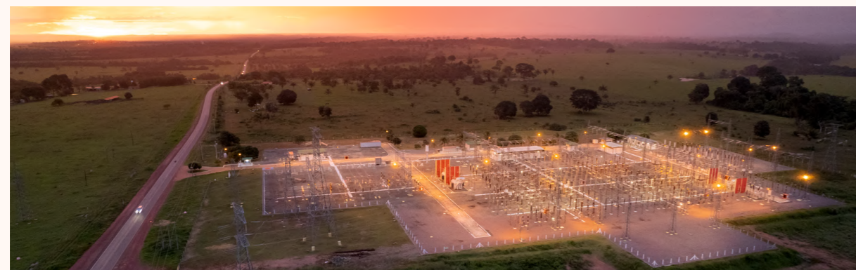
Subestação Pimenta Bueno, JTE
