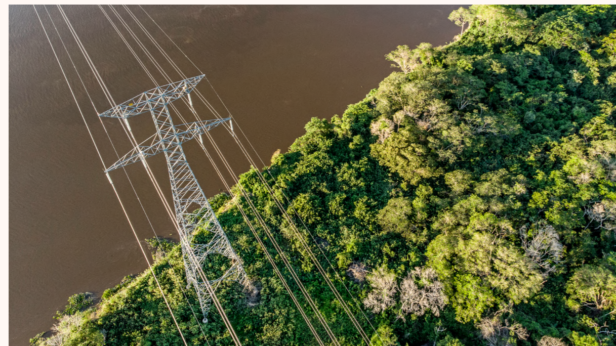
Subestação Vilhena, JTE
