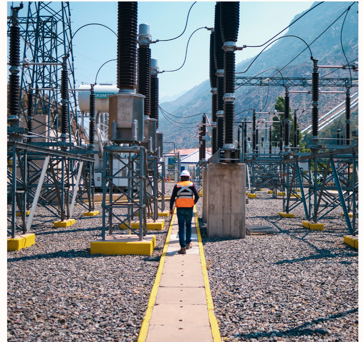
Subestação Los Maquis, Alfa
