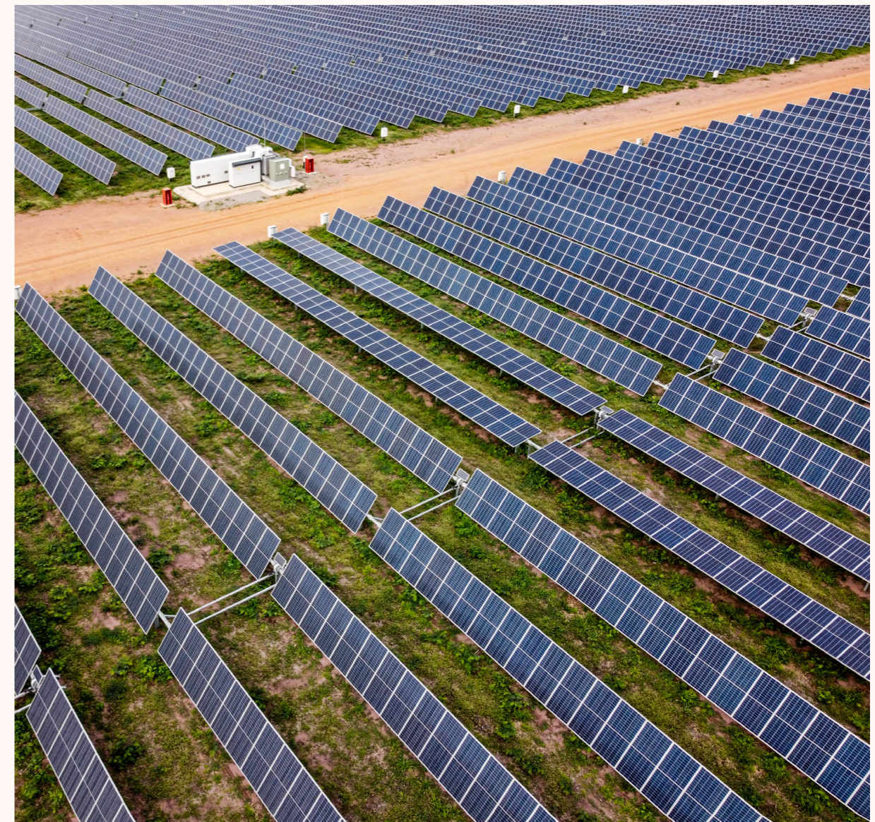
Usina fotovoltaica São João do Piauí (UFV-JSP)
