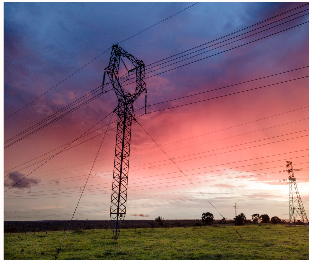
Linha de transmissão Jauru
