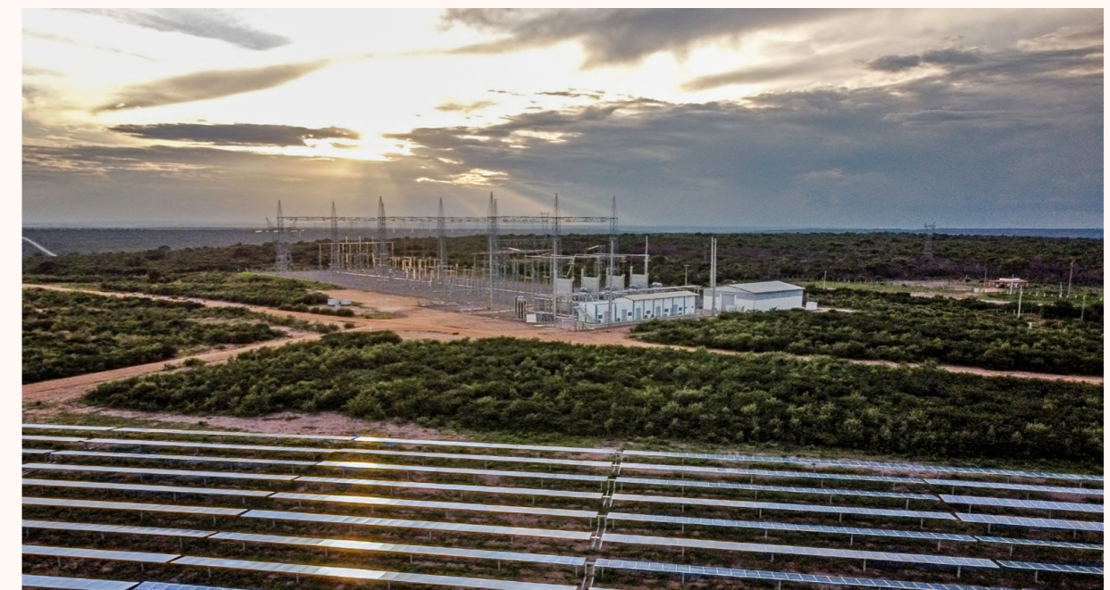
Usina fotovoltaica São João do Piauí (UFV-JSP)
