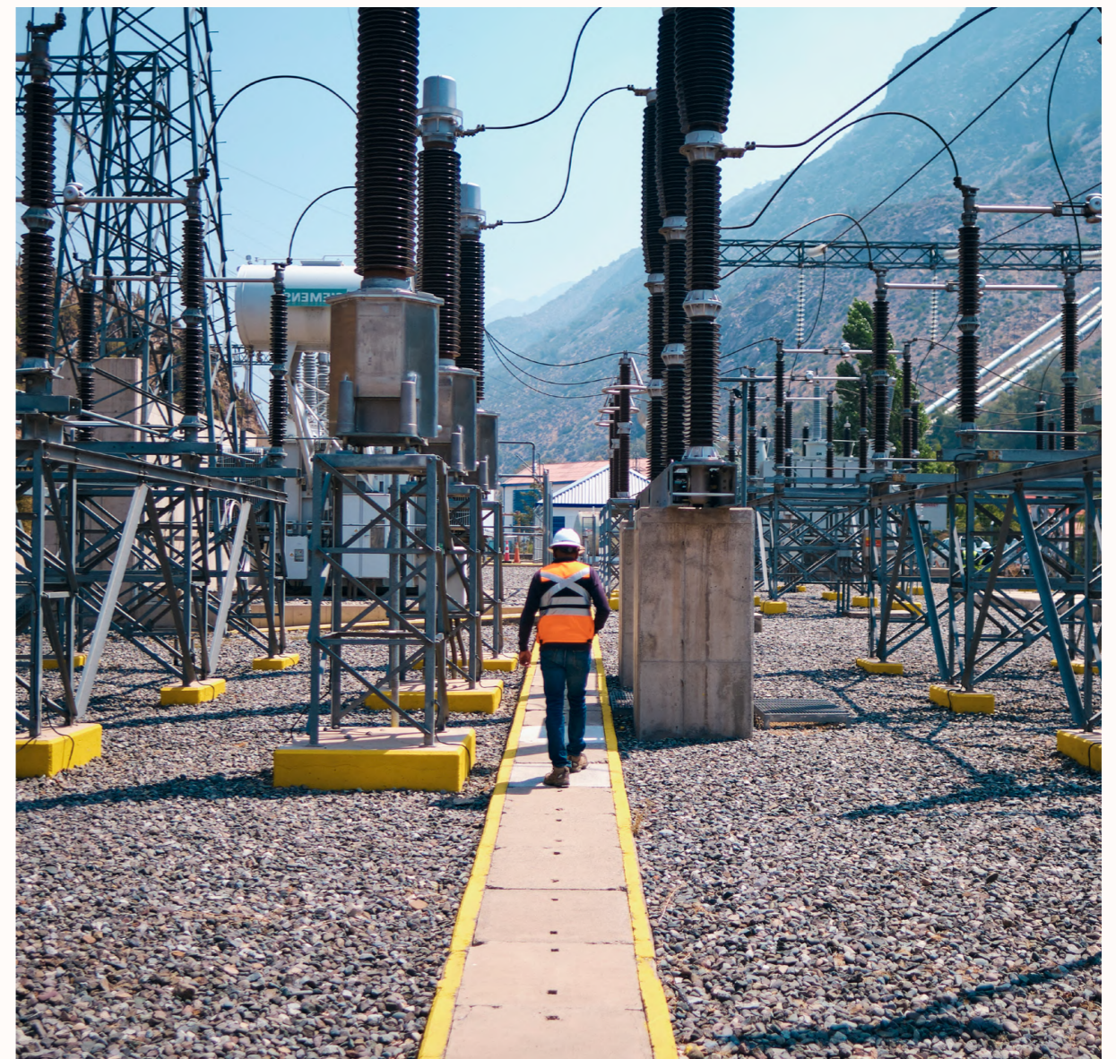
Los Maquis substation, Alfa
